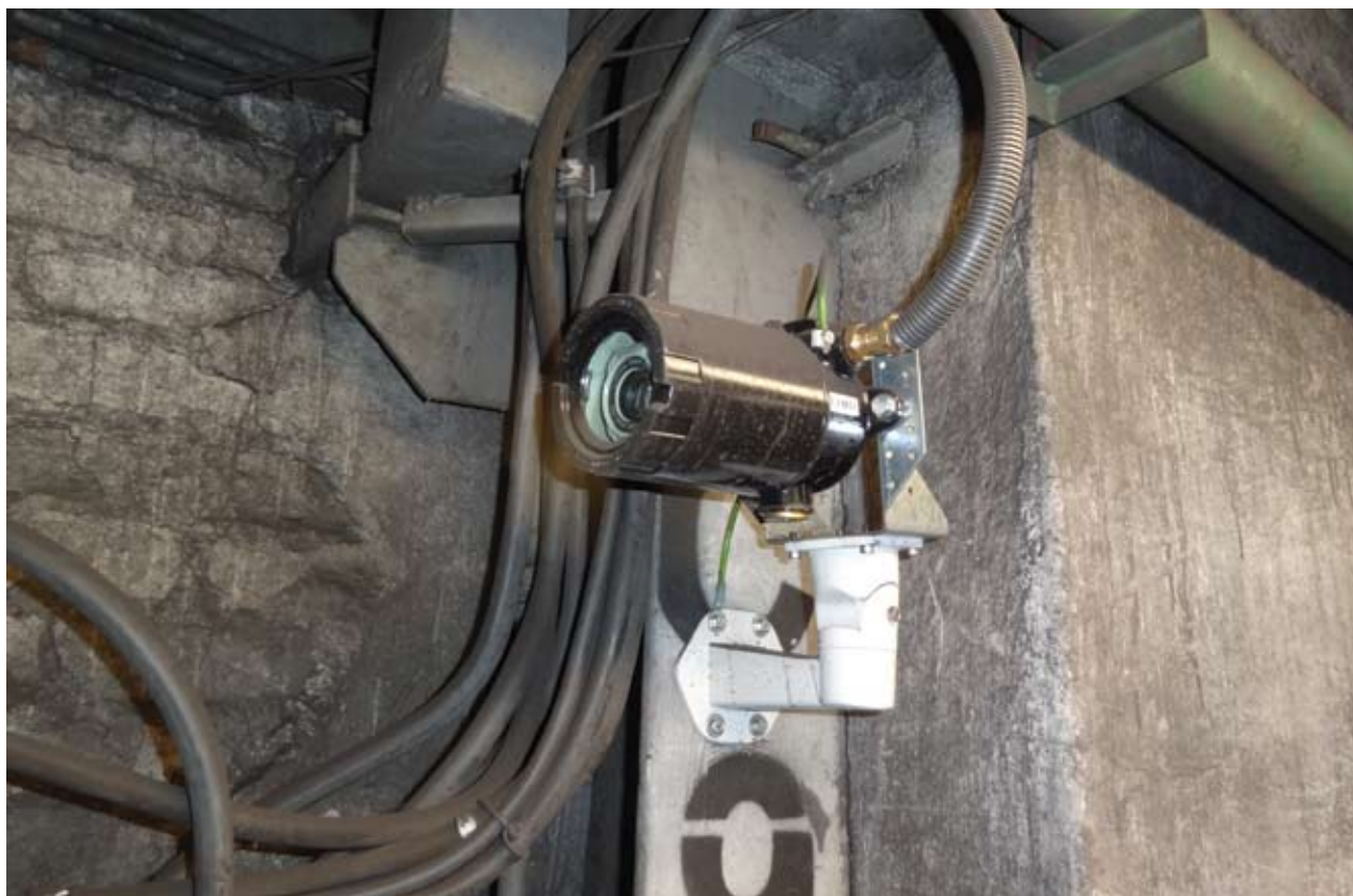
Kamera ASE C-Ex27-01 umieszczona przy nadzorze przenośników taśmowych
