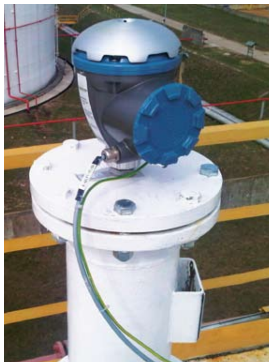
Radar typu 5900 zainstalowany na rurze DN200
