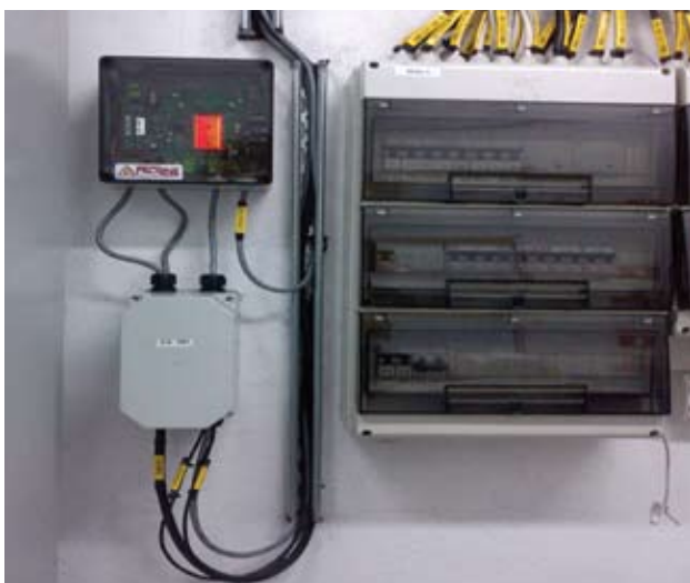
Zainstalowana centralka ZI-02
