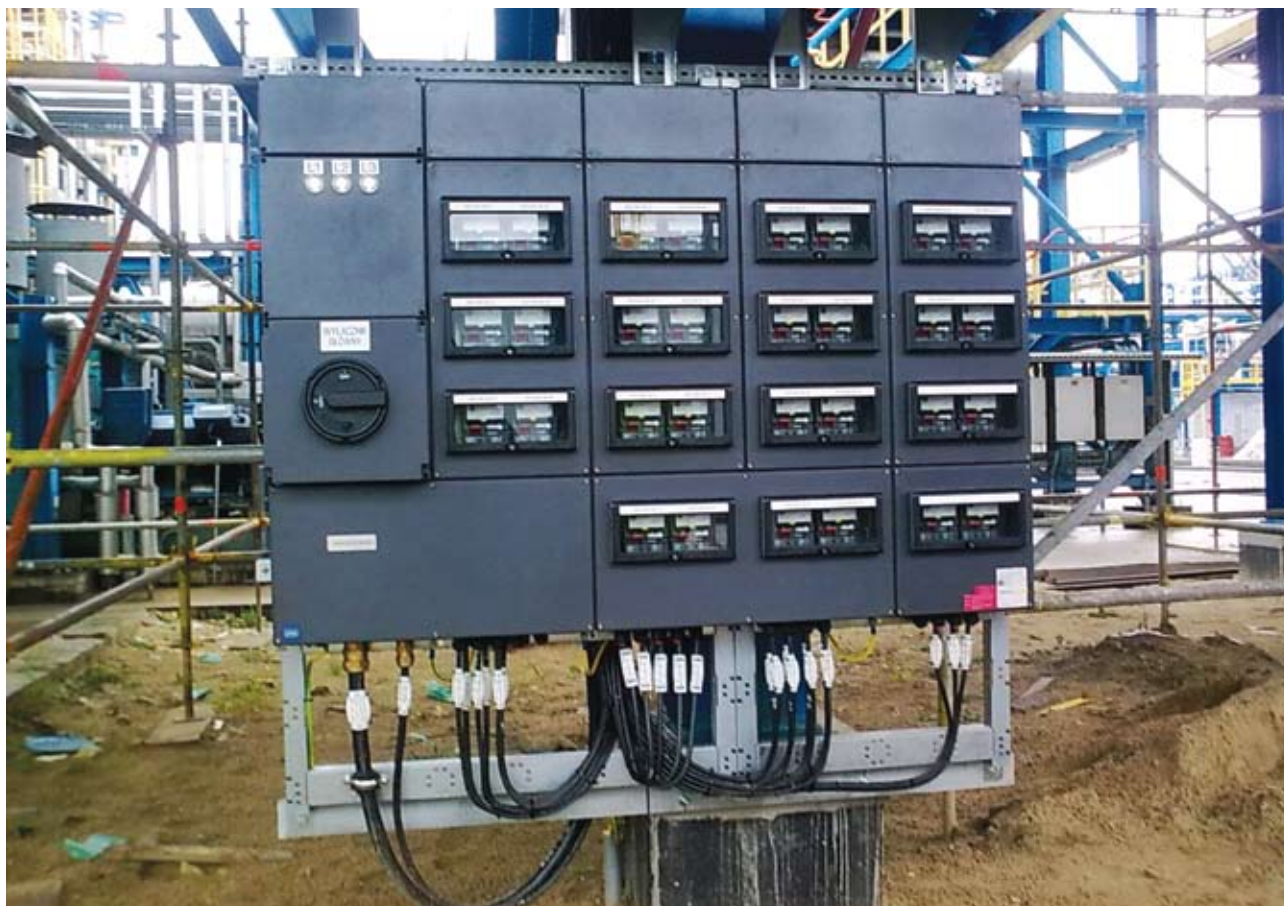
Typowa rozdzielnica do zasilania systemu ogrzewania elektrycznego
