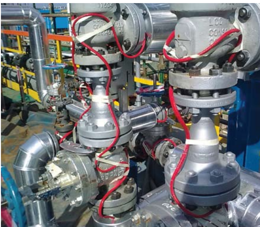
Kable grzejne na instalacji
