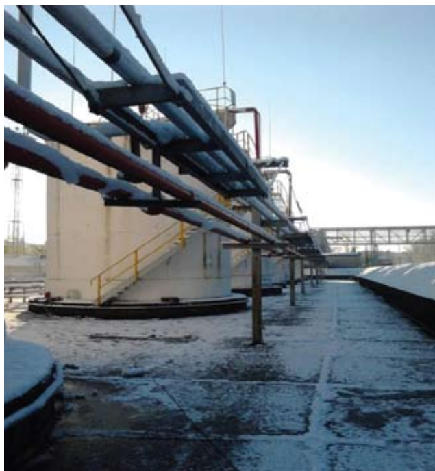
Zbiorniki posadowione w tacy
