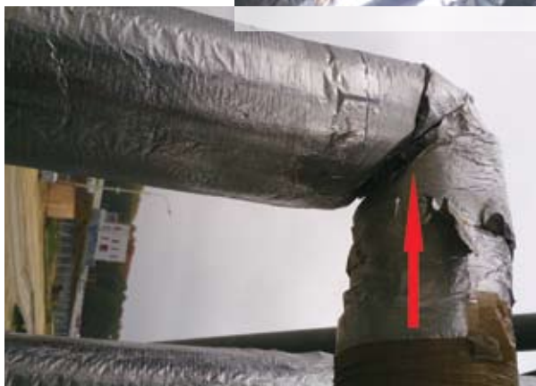
Ubytki w izolacji wpływają na miejscowe niedogrzanie
