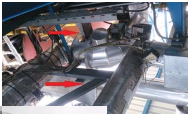
Nie ocieplone podpory powodują duże straty ciepła
