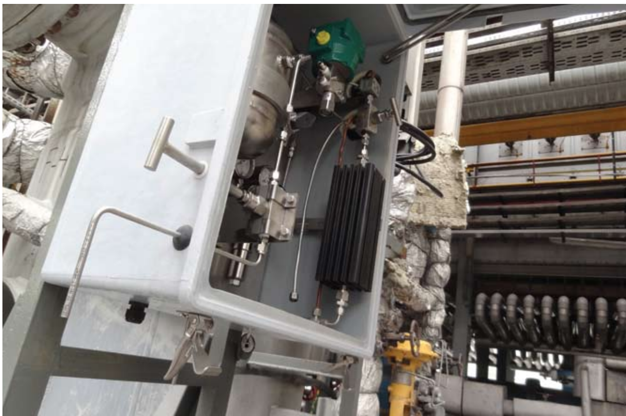
Szafka do poboru próbek dostarczona przez ASE zamontowana na instalacji
