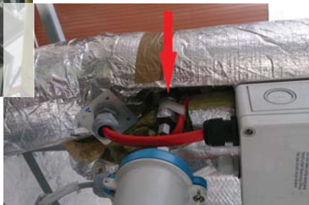
Wykryte braki izolacji termicznej
