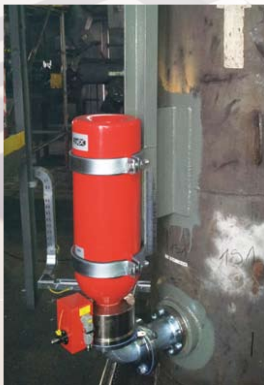
Zdjęcie zamontowanej butli HRD
