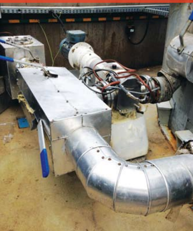
Fragment instalacji z widocznymi ubytkami produktu
