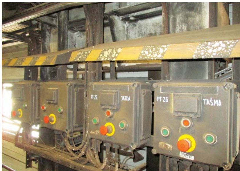
Skrzynki sterowania lokalnego
