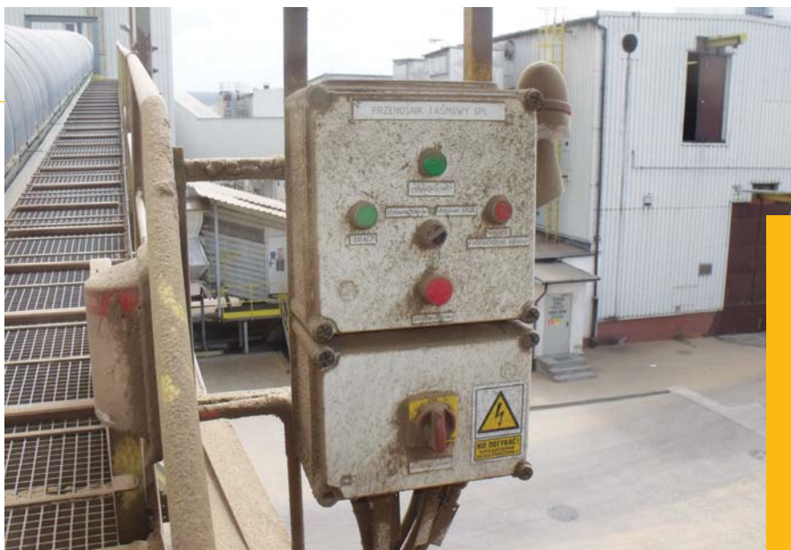
Skrzynka sterowania lokalnego przenośnika taśmowego
