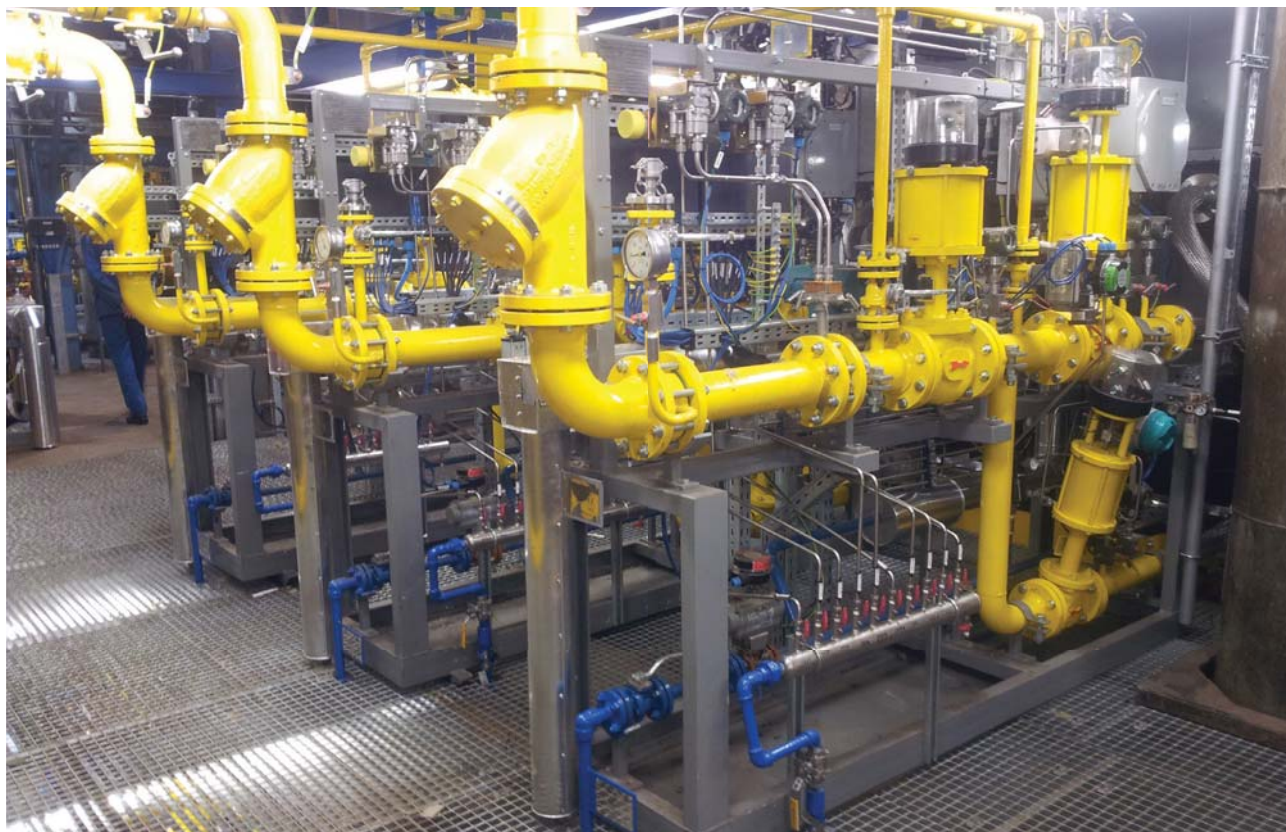
Kocioł K2. Skid gazowo-olejowy
