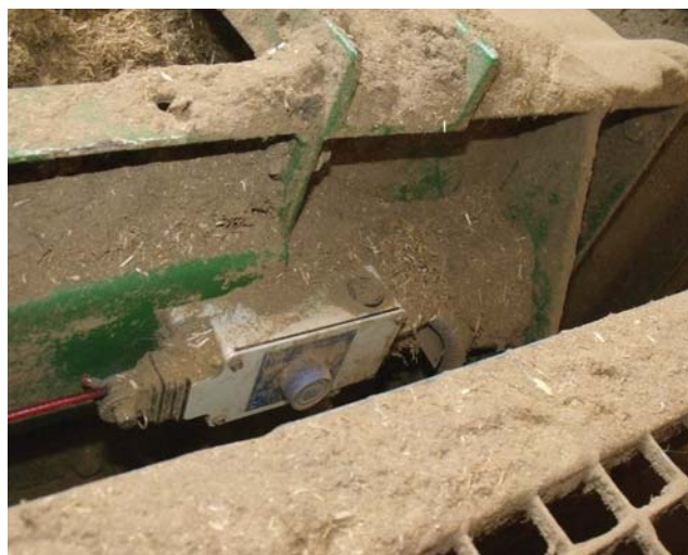
Wyłącznik linkowy. Instalacja biomasy
