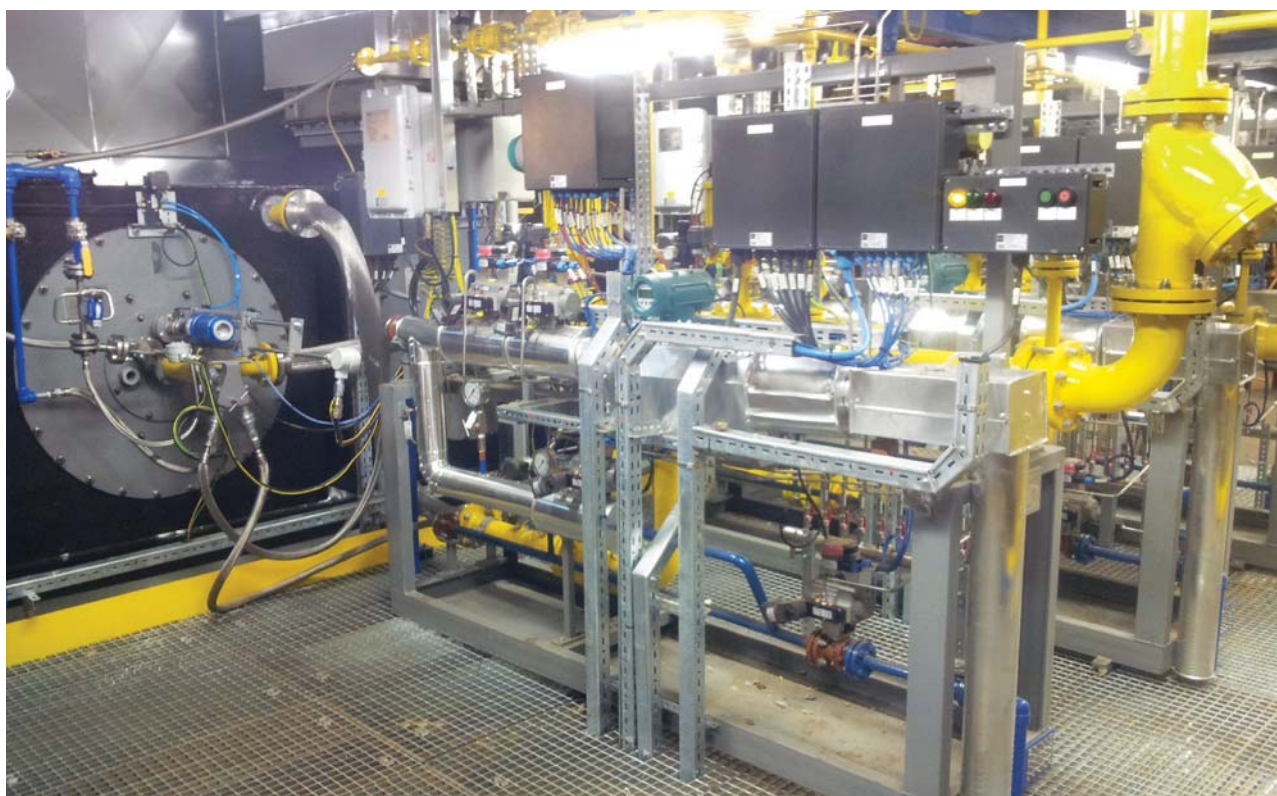
Kocioł K2. Skid gazowo-olejowy
