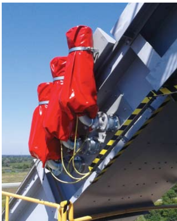
Butle tłumienia wybuchów na instalacji biomasy
