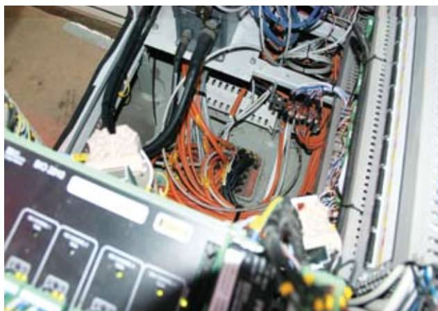
Przejście kablowe zastosowane na mostku kapitańskim.
