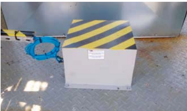
Czujniki ciśnienia PXD na instalacji biomasy zabudowane osłoną pogodową
