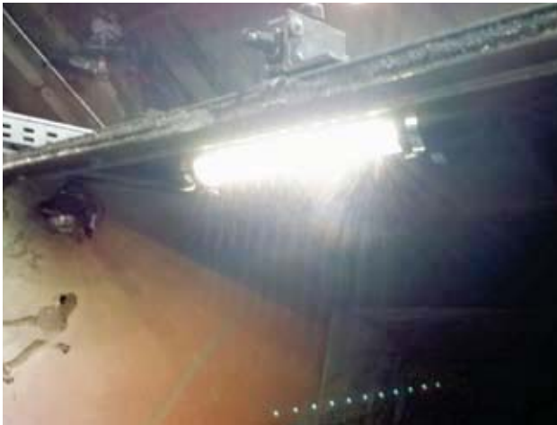
Oprawa LED 6039 wraz z kamerą EC-710 w miejscu trudno dostępnym
